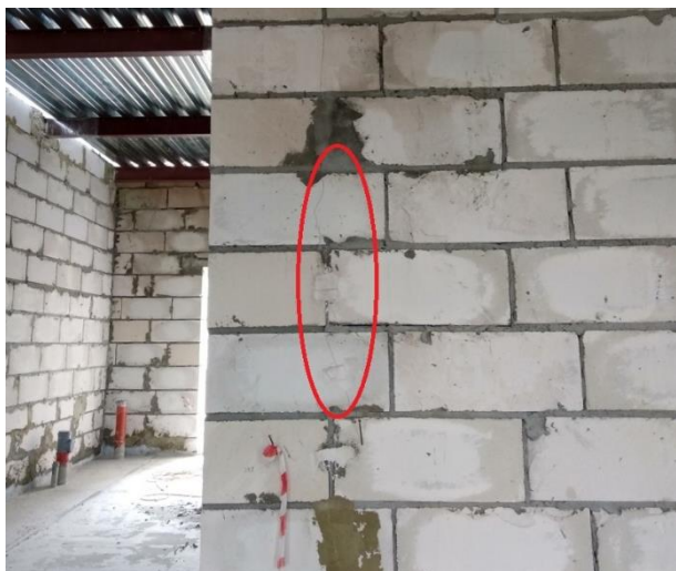
Рисунок 2. Локализованный дефект в виде трещины с установленными маячками (выполнено автором)
