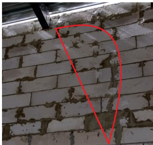
Рисунок 3. Локализованный дефект в виде трещины с установленными маячками (выполнено автором)
