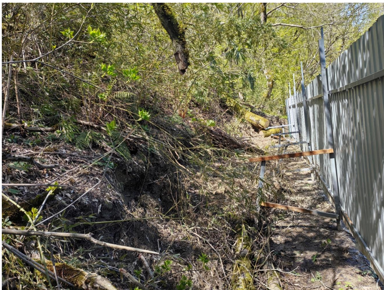
Рисунок 1. Смещения грунта, спровоцированные подрезкой склона в период устройства ограждения (фото автора)
