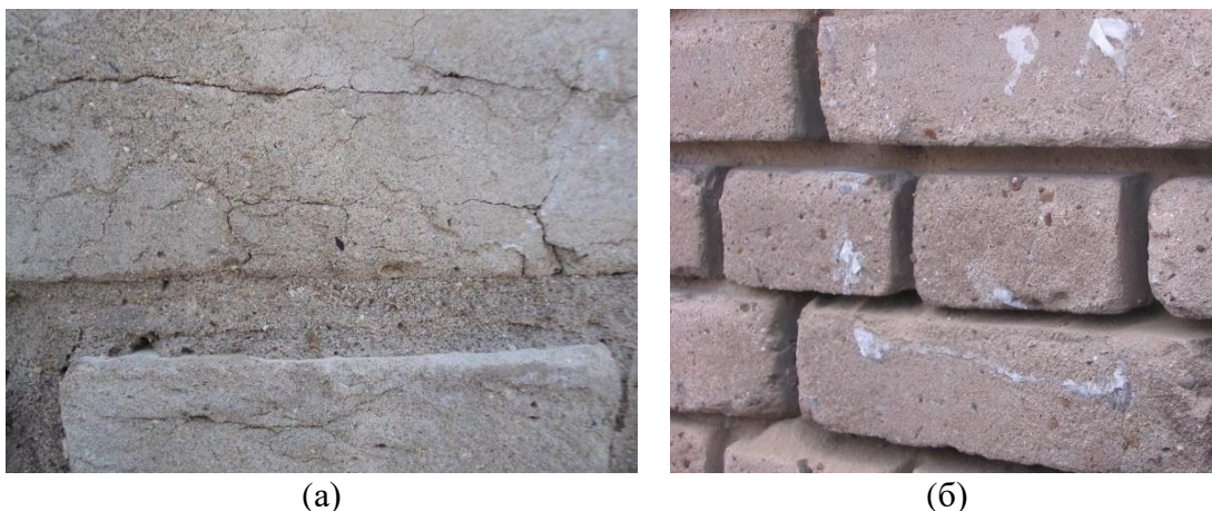
Рисунок 3. Физическая коррозия и эрозия кладки наружных стен жилых домов: (а) жилой дом 1942 г. (глубина до 8–10 мм); (б) жилой дом 1965 г. (глубина до 3–4 мм) (подготовлено авторами)
