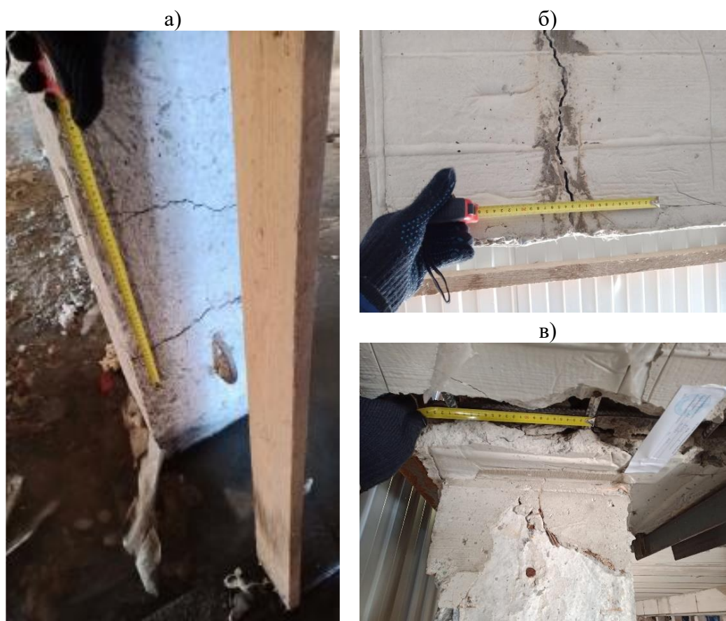
Рисунок 4. Характерные дефекты конструкций:
