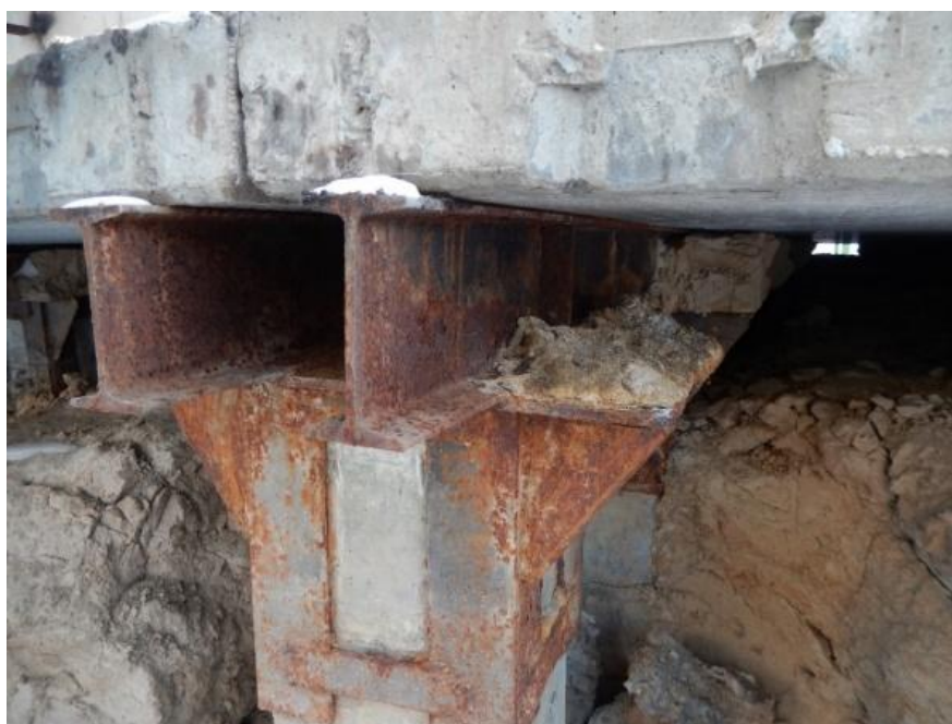
Рисунок 3. Коррозия оголовков свай и балок резервуара (составлено авторами)
