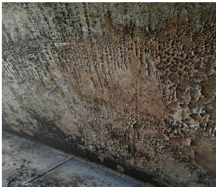
Рисунок 5. Коррозия внутренней стенки резервуара (составлено авторами)
