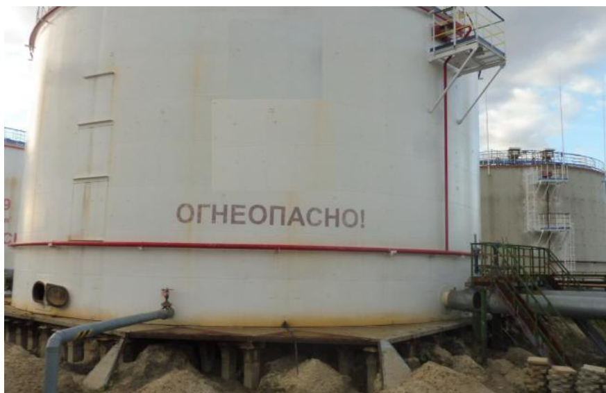
Рисунок 2. Очаги коррозии на стенках резервуара и в районе уторного шва (составлено авторами)
