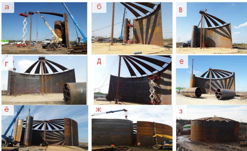
Рисунок 12. Некоторые процессы сборки резервуара из рулонных заготовок: а — установка главной (центральной) несущей стойки, монтаж первого (нечетного) радиального элемента крыши; б — монтаж последующих нечетных радиальных элементов крыши; в, г, д, е — продолжение процесса развертывания рулона вертикальной стенки РВС с одновременным монтажом остальных радиальных элементов крыши; ё, ж — начало и окончание развертывания второго рулона вертикальной стенки РВС; з — внешний вид РВС с полностью собранной стенкой и частично собранной крышей; и — внешний вид полностью собранной крыши с внутренней стороны резервуара ( http://www.мск-юг.рф/portfolio/montazh-rvs-10000m3.html )
