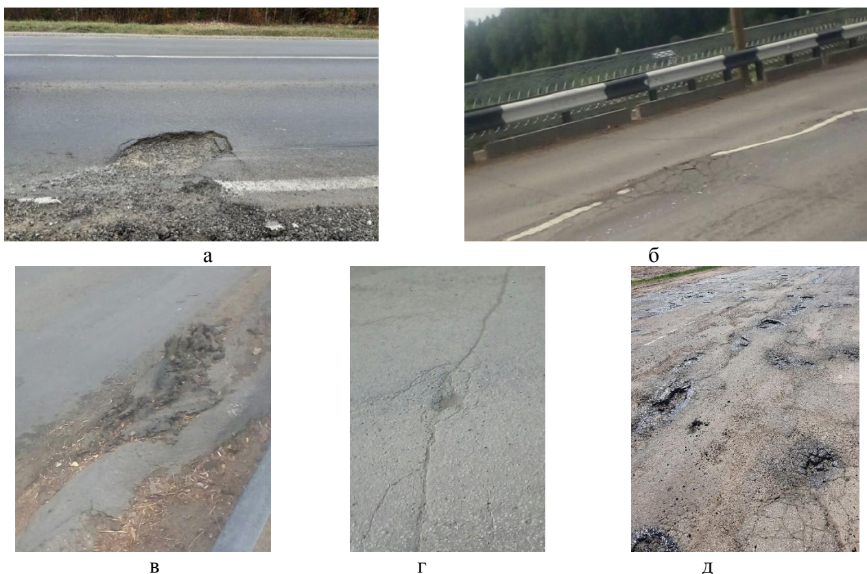
Рисунок 1. Дефекты дорожного покрытия на дорогах общего пользования (фото выполнено авторами)
