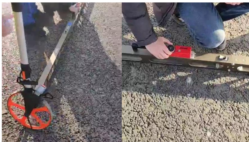
Рисунок 2. Измерение дефектов дорожного покрытия от необратимой деформации с использованием дорожной рейки (фото выполнено авторами)
