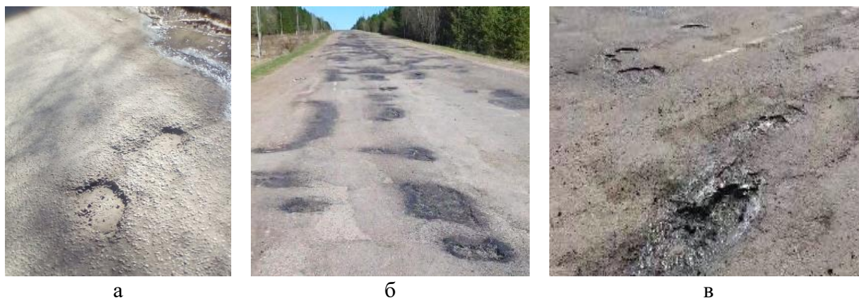
Рисунок 1. Дефекты верхнего слоя дорожного покрытия на дорогах общего пользования (фото выполнено авторами)
