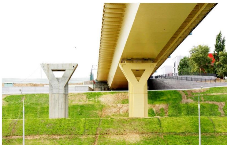
Рисунок 8. Фрагмент окраски опоры моста через р. Волгу в г. Волгограде [3]
