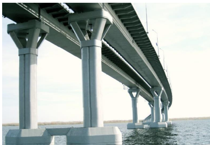
Рисунок 7. Фрагмент окраски опоры моста через р. Волгу у г. Саратова [3]
