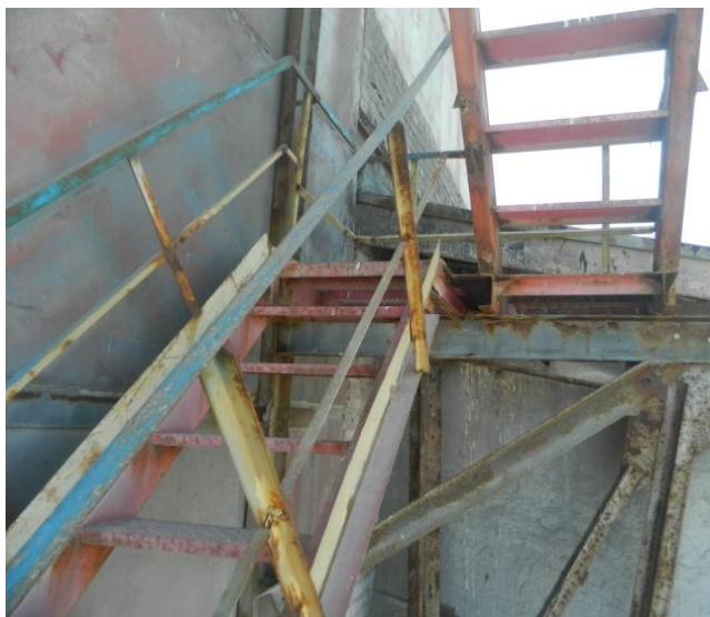
Рисунок 7. Коррозия металлических конструкций здания (фото составлено Таранухина В.О., Мегедь Т.К., Ильенко М.Ш., Соловьева Е.В.)
