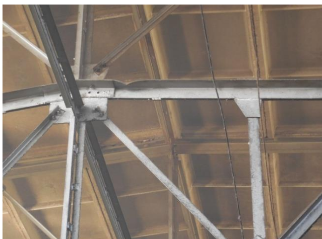
Рисунок 15. Выгибы из проектной плоскости верхних и нижних поясов ферм (фото составлено Таранухина В.О., Мегедь Т.К., Ильенко М.Ш., Соловьева Е.В.)
