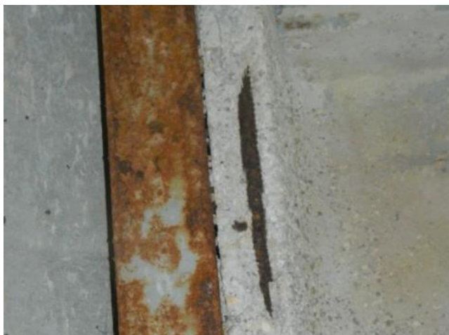
Рисунок 25. Оголение и коррозия арматуры в железобетонных конструкциях покрытия и перекрытия (фото составлено Таранухина В.О., Мегедь Т.К., Ильенко М.Ш., Соловьева Е.В.)
