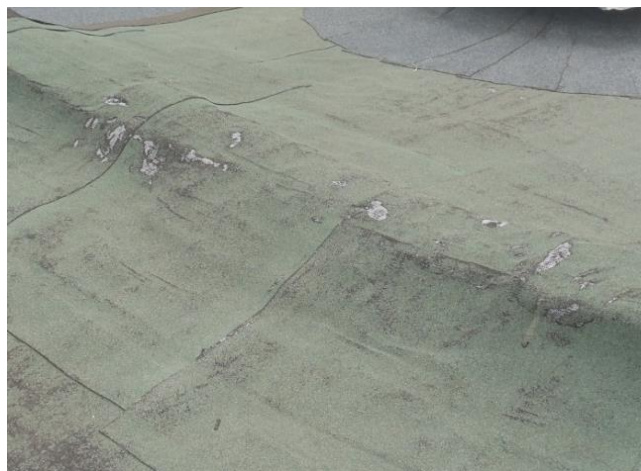
Рисунок 28. Повреждение водоизоляционного кровельного покрытия (фото составлено Таранухина В.О., Мегедь Т.К., Ильенко М.Ш., Соловьева Е.В.)
