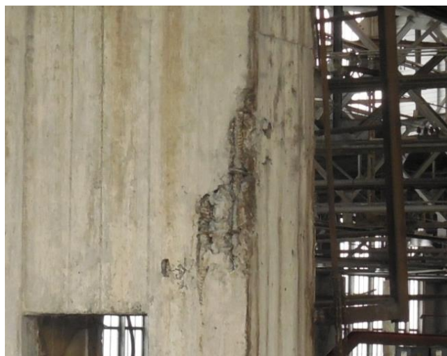
Рисунок 20. Непровибрированные участки железобетонных конструкций (фото составлено Таранухина В.О., Мегедь Т.К., Ильенко М.Ш., Соловьева Е.В.)
