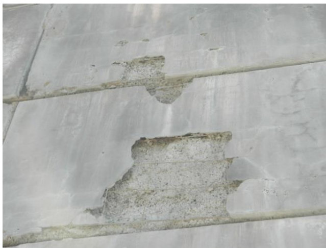
Рисунок 10. Разрушение защитного слоя бетона в стеновых панелях (фото составлено Таранухина В.О., Мегедь Т.К., Ильенко М.Ш., Соловьева Е.В.)
