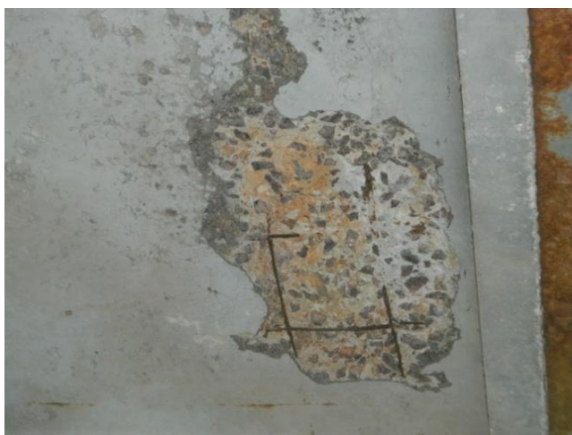
Рисунок 24. Разрушения защитного слоя бетона в конструкция покрытия и перекрытия (фото составлено Таранухина В.О., Мегедь Т.К., Ильенко М.Ш., Соловьева Е.В.)
