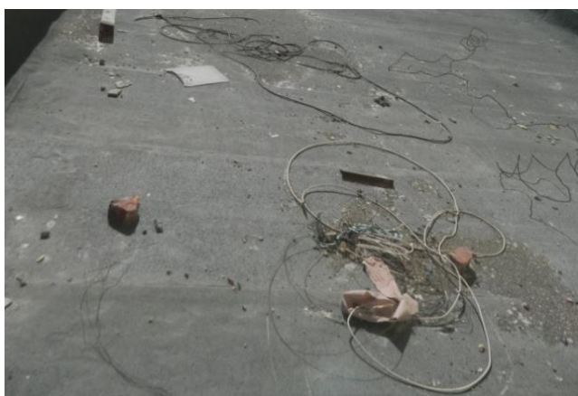
Рисунок 27. Складирования строительного и иного мусора на кровле здания (фото составлено Таранухина В.О., Мегедь Т.К., Ильенко М.Ш., Соловьева Е.В.)
