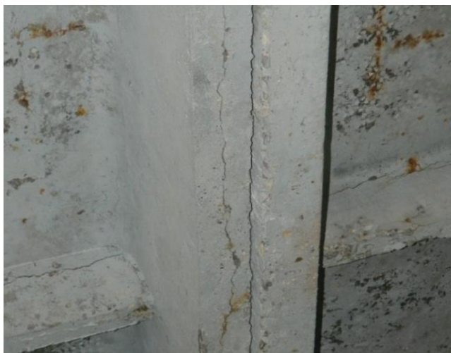
Рисунок 23. Коррозионные трещины в железобетонных конструкция покрытия и перекрытия (фото составлено Таранухина В.О., Мегедь Т.К., Ильенко М.Ш., Соловьева Е.В.)
