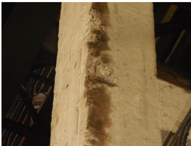
Рисунок 22. Оголение рабочей арматуры колонн каркаса здания (фото составлено Таранухина В.О., Мегедь Т.К., Ильенко М.Ш., Соловьева Е.В.)
