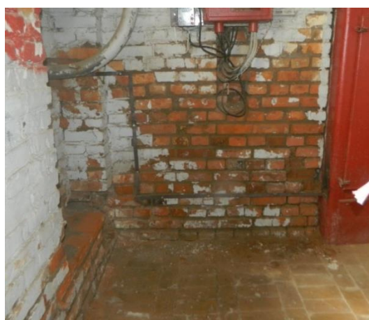
Рисунок 6. Повреждение защитного лакокрасочного и штукатурного покрытия строительных конструкций (фото составлено Таранухина В.О., Мегедь Т.К., Ильенко М.Ш., Соловьева Е.В.)
