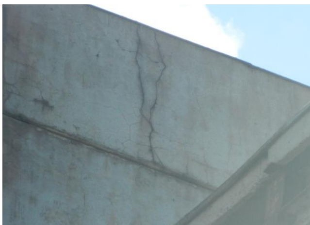
Рисунок 9. Трещины в железобетонных стеновых панелях (фото составлено Таранухина В.О., Мегедь Т.К., Ильенко М.Ш., Соловьева Е.В.)
