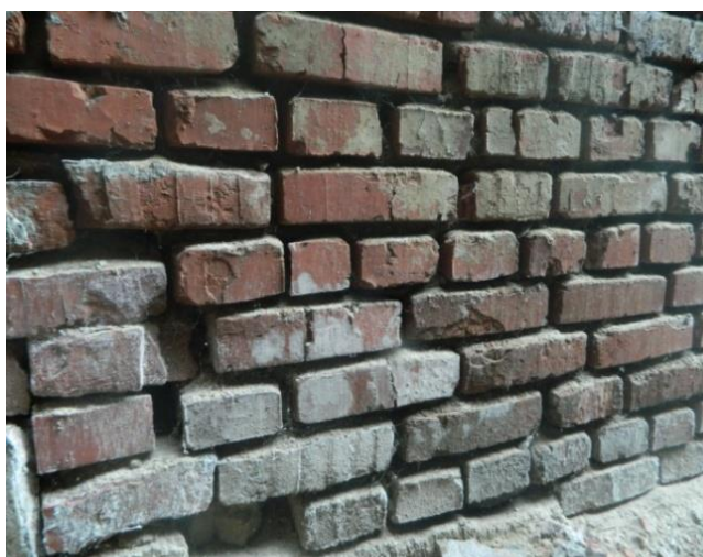
Рисунок 12. Выщелачивание кладочного раствора кирпичных стен (фото составлено Таранухина В.О., Мегедь Т.К., Ильенко М.Ш., Соловьева Е.В.)
