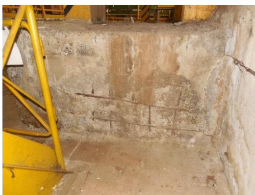
Рисунок 3. Разрушение защитного слоя бетона фундамента с оголением рабочей арматуры (фото составлено Таранухина В.О., Мегедь Т.К., Ильенко М.Ш., Соловьева Е.В.)
