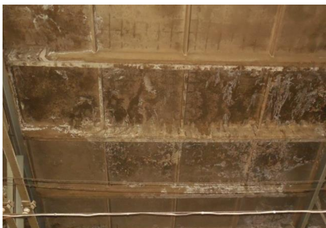
Рисунок 26. Замачивание строительных конструкций (фото составлено Таранухина В.О., Мегедь Т.К., Ильенко М.Ш., Соловьева Е.В.)
