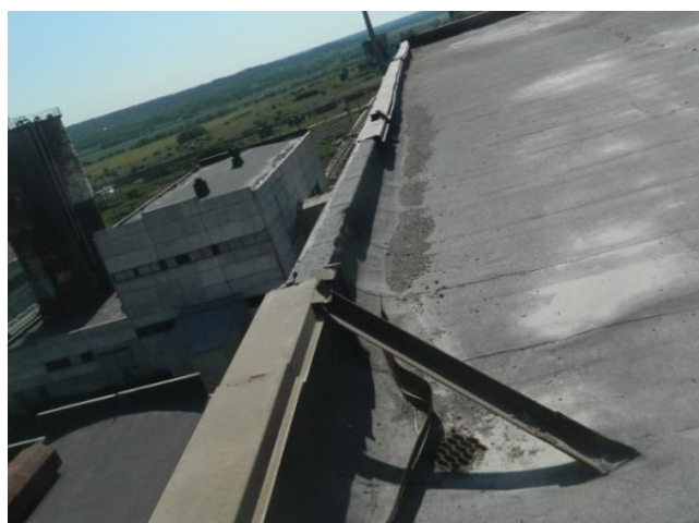
Рисунок 29. Отсутствуют, либо повреждены защитные отливы на кровле здания (фото составлено Таранухина В.О., Мегедь Т.К., Ильенко М.Ш., Соловьева Е.В.)
