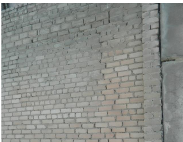
Рисунок 11. Трещины в кирпичной кладке стен (фото составлено Таранухина В.О., Мегедь Т.К., Ильенко М.Ш., Соловьева Е.В.)
