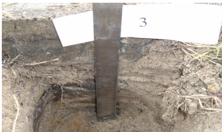
Рисунок 4. Определение толщин (цементно-грунтовой и песко-цементной смесей и железобетонной плиты покрытия) (выполнено авторами)
