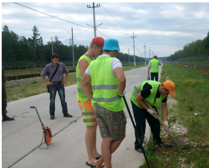
Рисунок 1. Выполнение подкопа под железобетонную плиту справа от оси автомобильной дороги (выполнено авторами)
