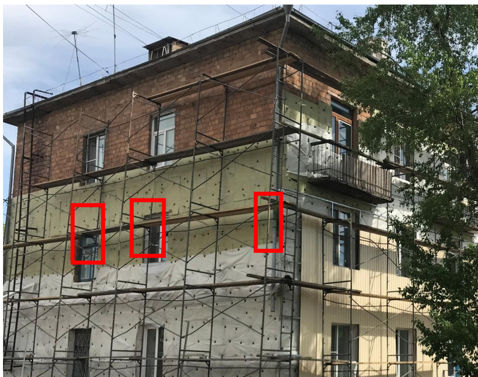
Рисунок 6. Дефекты монтажа навесных фасадных систем (разработано авторами)
