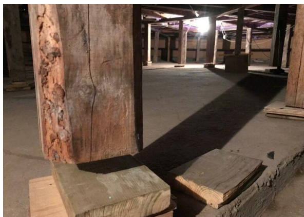
Рисунок 2. Смещение опор в церкви Богоматери Победы в результате протаивания, Инувик ( https://www.cbc.ca/news/canada/north/the-national-permafrost-thaw-inuvik-tuktoyaktuk-1.5179842 )
