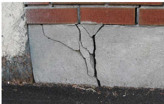
Рисунок 1. Трещины в фундаменте, образовавшиеся в результате морозного пучения ( https://www.ecohome.net/guides/3628 )
