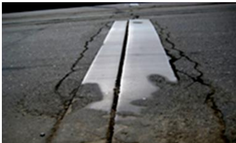
Рисунок 1. Трещины в покрытии у шва, разрушение покрытия в зоне шва (фото выполнено авторами)
