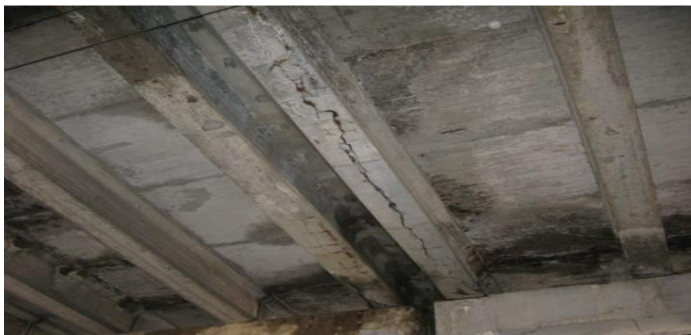
Рисунок 3. Появление коррозионной трещины в защитном слое ребра балки пролетного строения (фото авторов)
