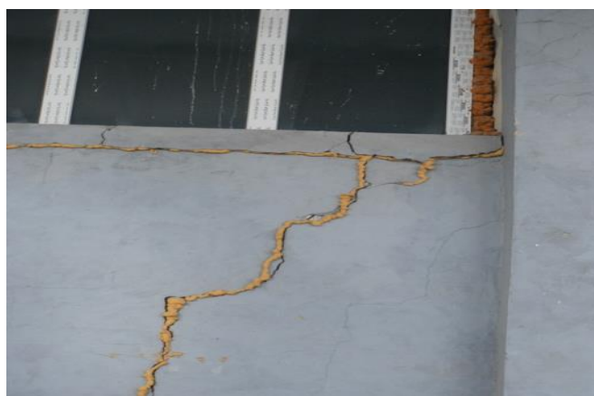
Рисунок 2. Запеченные трещины в наружных стенах здания манежа (составлено автором)
