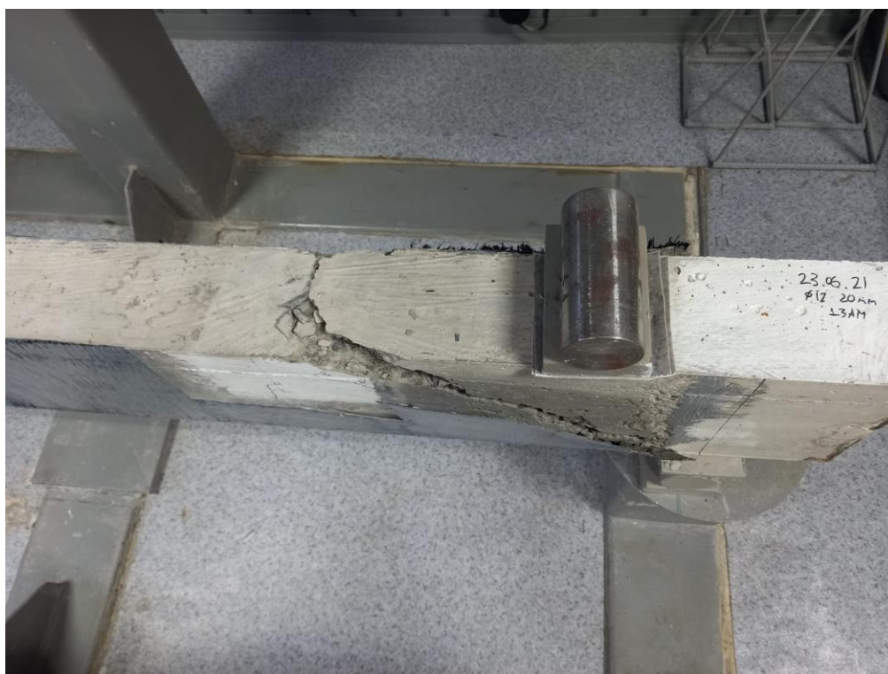
Рисунок 7. Вид сверху разрушения балки по наклонному сечению (фото авторов)
