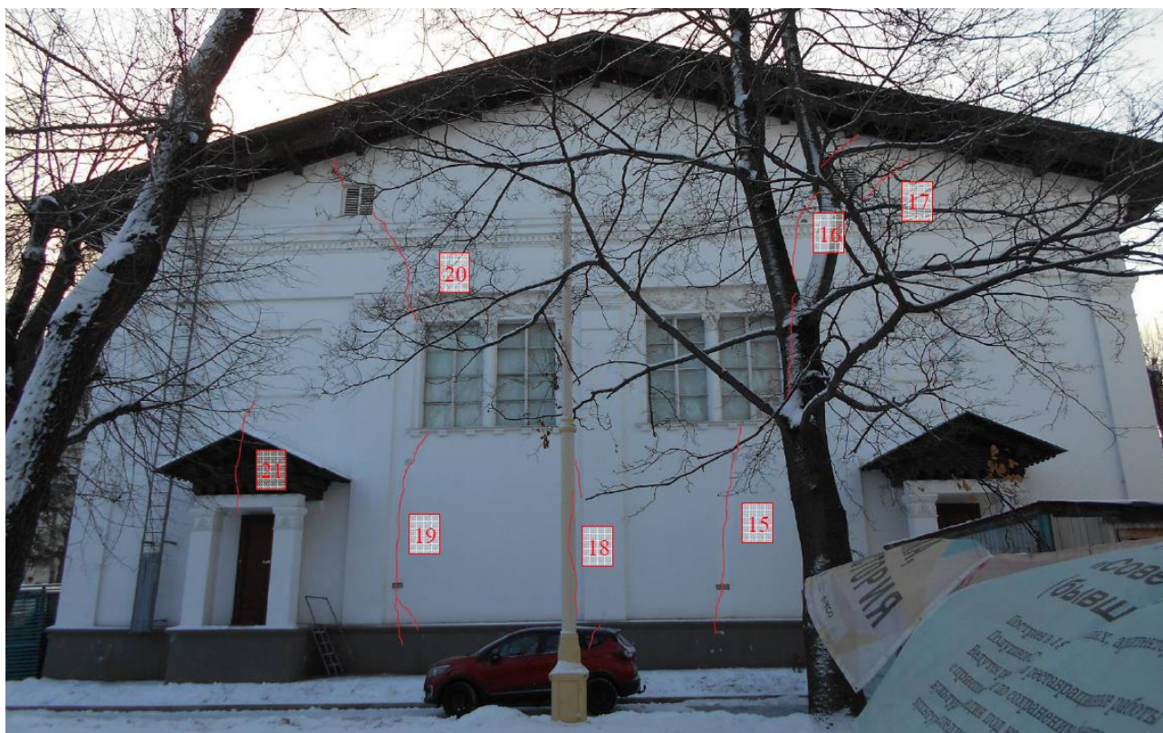
Рисунок 4. Схема деформационных трещин, отмеченных на заднем фасаде в осях 10–1 павильона №67 «Карелия» [5]
