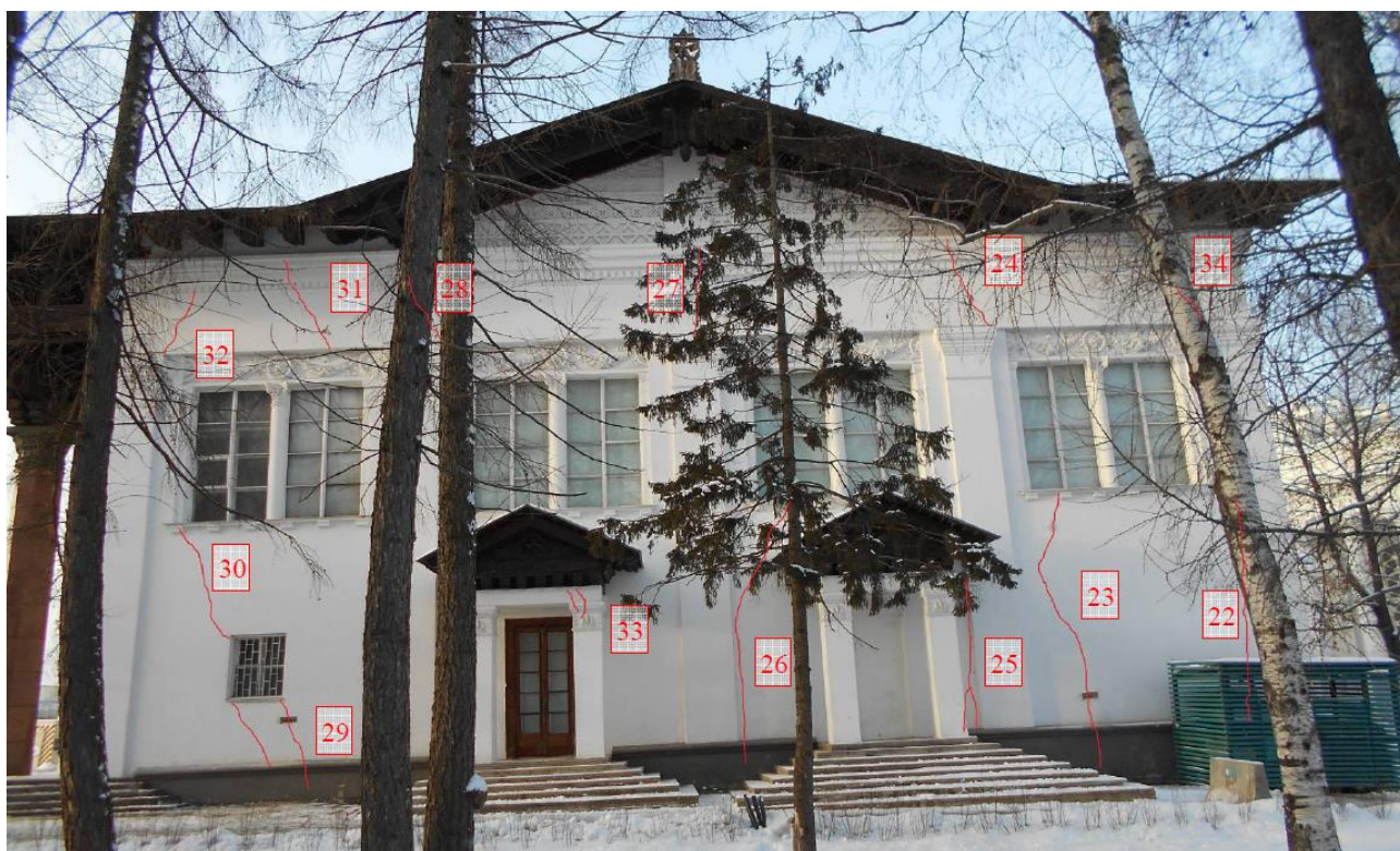
Рисунок 3. Схема деформационных трещин, отмеченных на боковом фасаде в осях А–Е павильона №67 «Карелия» [5]
