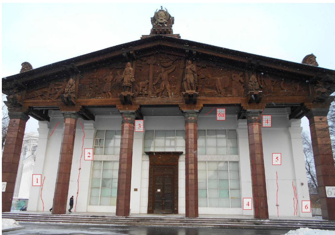
Рисунок 1. Схема деформационных трещин, отмеченных на главном фасаде в осях 1–10 павильона №67 «Карелия» при визуальном обследовании специалистами НИЛ ОРЗиС НИУ МГСУ в декабре 2018 г. [5]
