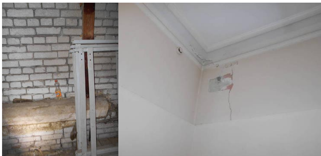
Рисунки 7–8. Вид внутри здания той же трещины шириной раскрытия до 5 мм в уровне чердака (рисунок 7) и под чердачным перекрытием (рисунок 8) [5]
