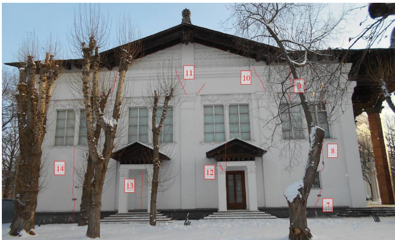
Рисунок 2. Схема деформационных трещин, отмеченных на боковом фасаде в осях Е–А павильона №67 «Карелия» [5]
